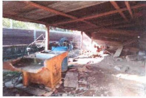
Foto 2: Galera que se necesita sustituir.
