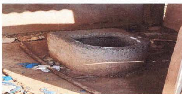
Foto 6: Se encuentra en mal estado el inodoro
