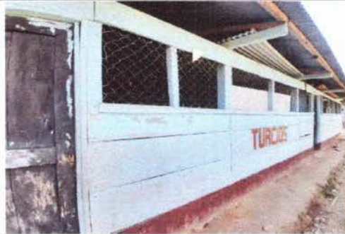
Foto 5: Pintura que se requiere sustituir.
