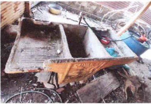
Foto 3: Pil que se requiere sustituir.
