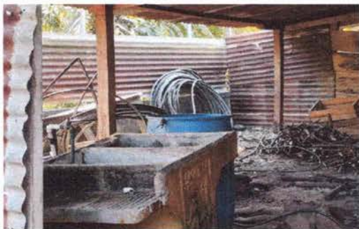
Foto 3: Se encuentra en malas condiciones el piso
